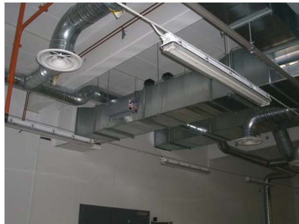
Negatieve ionen generator in kanaalwerk
